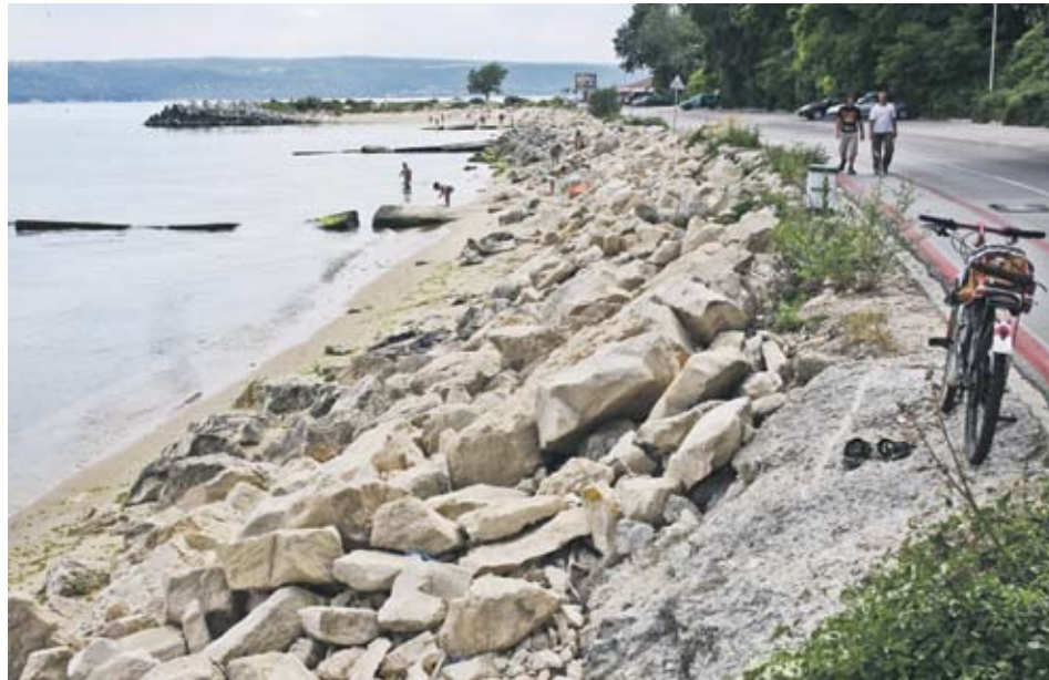
▶ На това място от бреговата ивица трябва да се изгради проектът „Алея първа” СНИМКА ЕМИЛИЯ КОСТАДИНОВА
