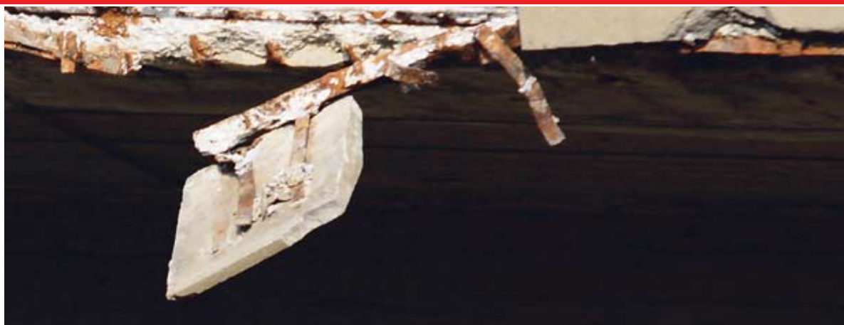
Един от основните проблеми преди началото на ремонта на бул. "Брюксел" бяха облицовъчните плочки на съоръжението, които започнаха да падат
