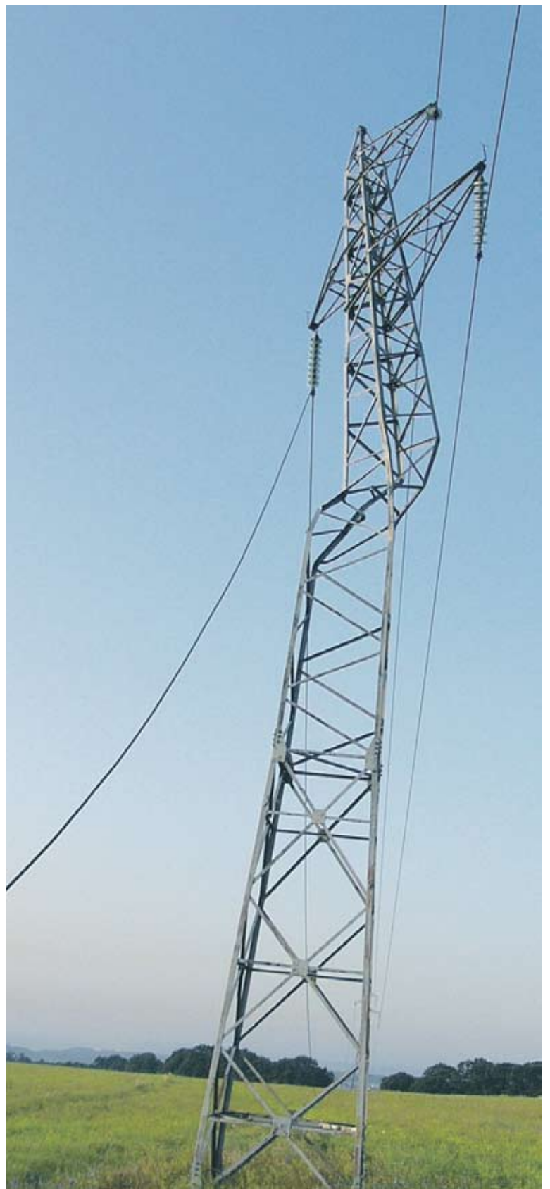
► Така изглежда единственият далекопровод, който захранва Черноморието
